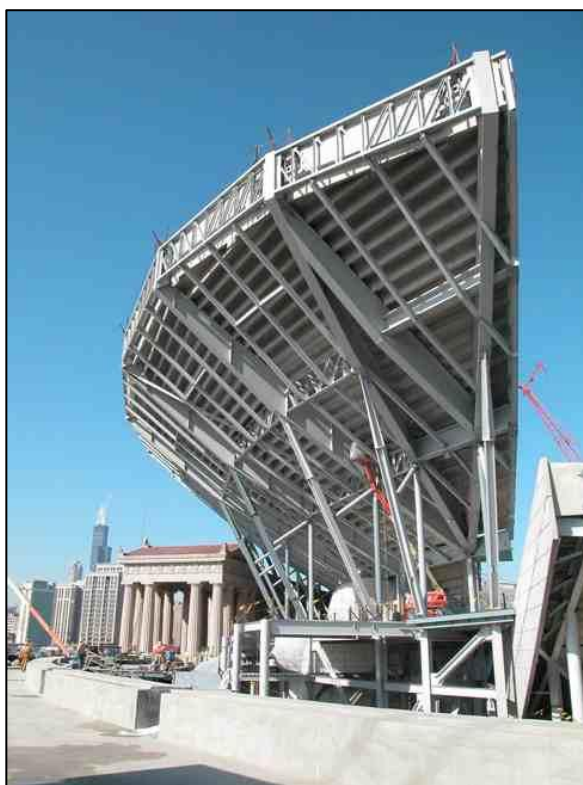
Figura 2.22 – Vista da nova arquibancada do Soldier Field, Chicago – Estados Unidos http://www.thorntomasetti.com/projects/soldier_field/ acesso em 23 de fevereiro de 2016
