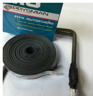
f) Proteção mecânica com fita isolante de auto fusão
