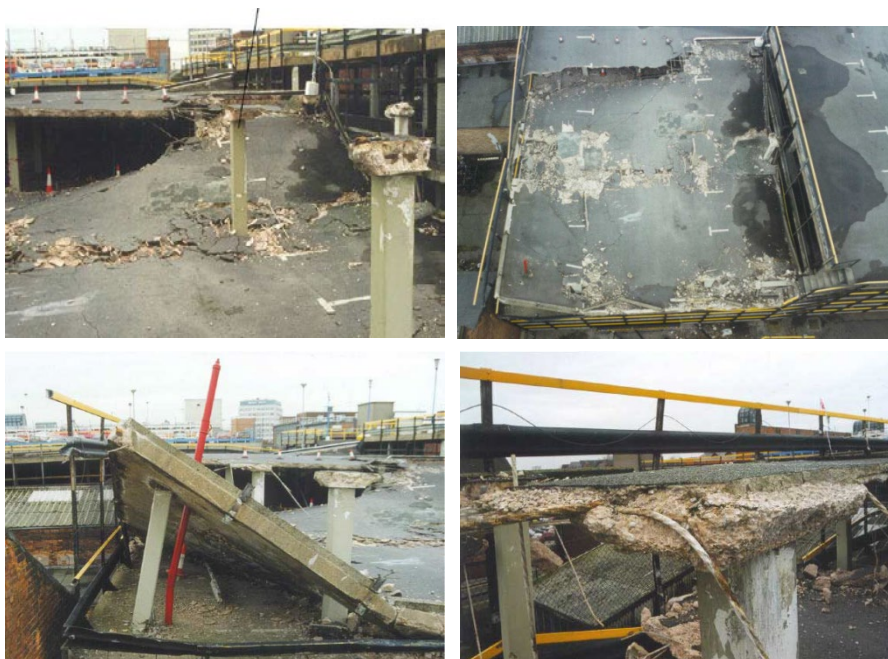
Figura 1.4 – Colapso por punção da laje do quarto pavimento do edifício Piper Row Car Park, Wolverhamptom, UK . [WOOD (1997)]
