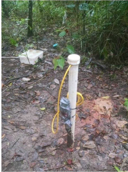
Figura 4.23 – Poço de observação dotado de linígrafo para monitoramento do nível da água no domínio aquífero poroso, instalado próximo à seção geofísica E (ao fundo).
