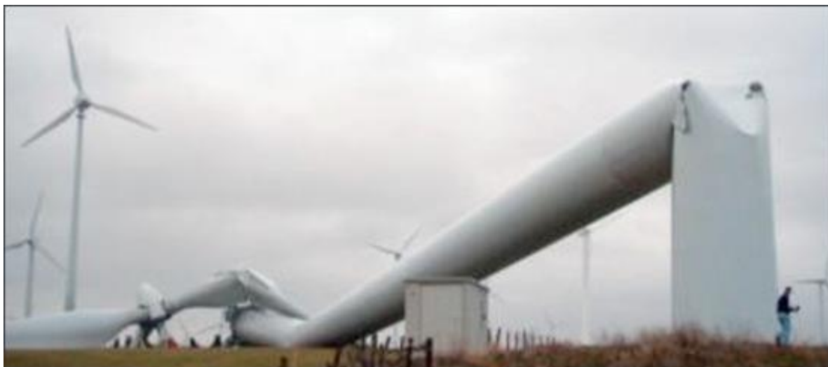
Figura 1.4 Colapso da torre de um aerogerador (10).
