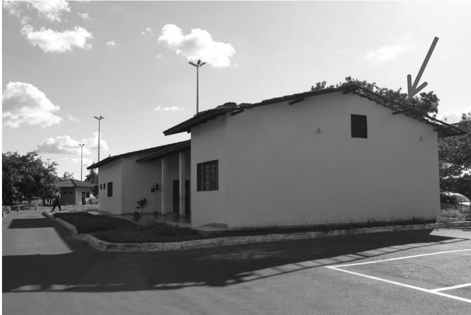
Figura 13: Sede instalada no Parque Ezechias Heringer com guarita instalada ao fundo. A seta aponta para o destelhamento da sede.
