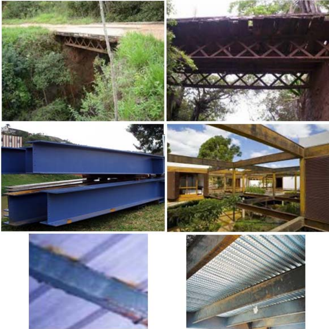
Figura 1.3 – Tipos de danos em vigas metálicas com naturezas diversas
