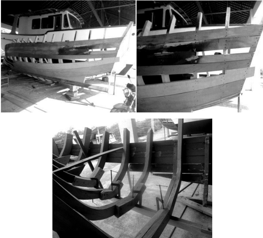
Figura 35 - Fechando o tabuado do bote proa de risco. No detalhe, a madeira escurecida pelo fogo para acompanhar as curvas comuns do barco. Em seguida, os grampos de ferro que ajudam na assentar (fixar) as peças no lugar adequado.
