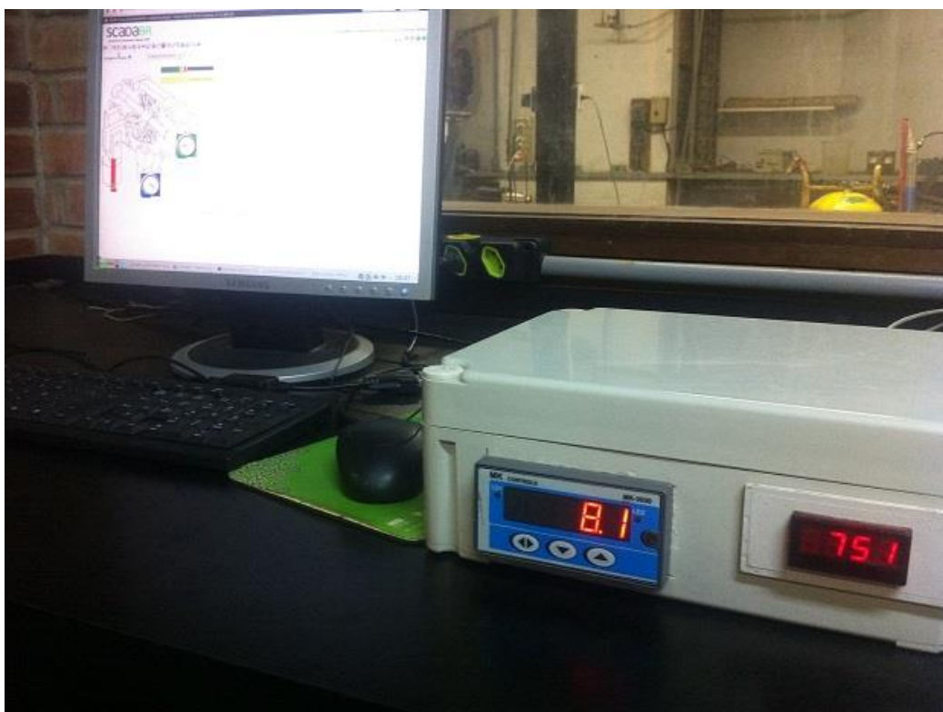
Figura 44. Novo sistema de Supervisão e Controle.
