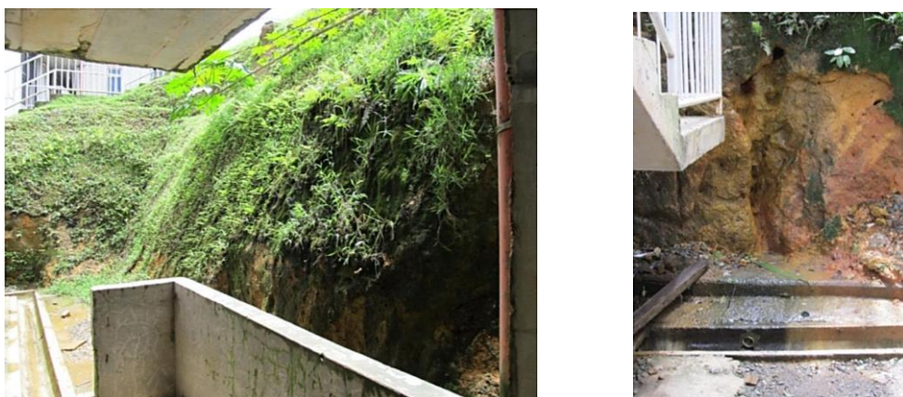
Figura 5.11 – infiltrações de água na Ciudadela Nuevo Occidente.
