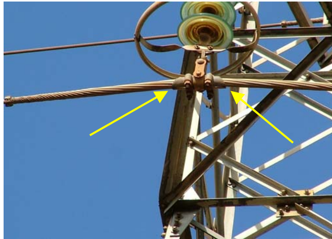
Figura 4.1 – Região onde ocorre a ruptura dos cabos condutores.
