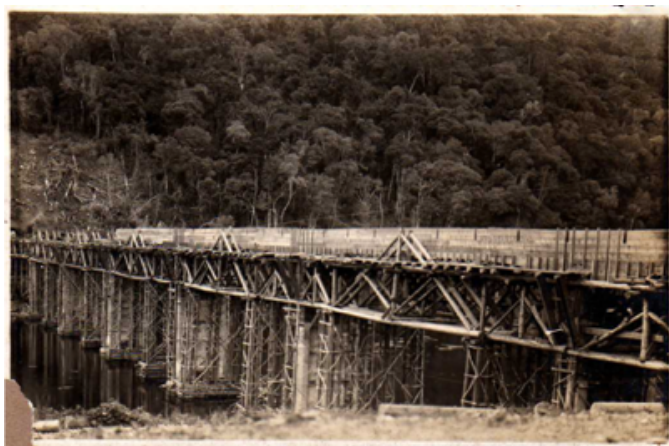
Figuras 66 – Foto da construção da Ponte sobre o rio Pelotas. FONTE: Acervo de documentos SEEBLA – Serviços de Engenharia Emílio Baumgart Ltda.; Belo Horizonte, 2013.
