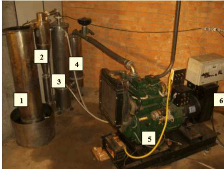
Figura 1.4: Planta de geração de potência operando 100% com biomassa (Rodrigues et al., 2009)
