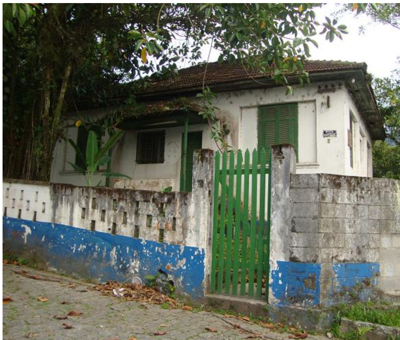
Algumas casas individuais foram construídas em uma área denominada Bosque e se destinavam a funcionários com posto mais elevado. Foto da autora. Jan. 2013.
