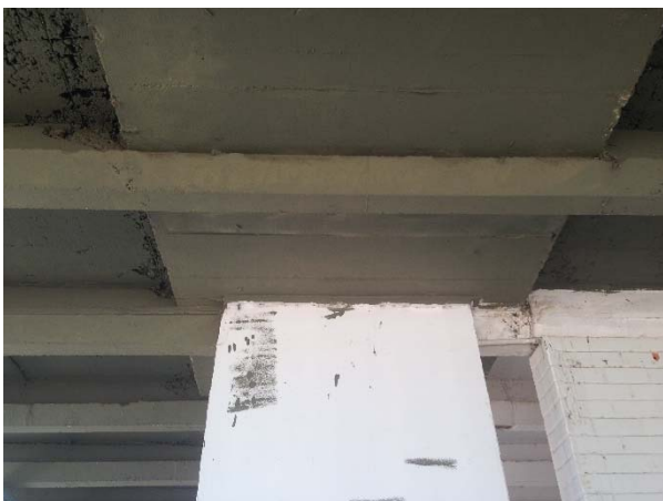
Figura 109: Detalhe vínculo pilar x Viga Mestra e Viga Mestra x Pilar. Fonte: Imagem do Autor.
