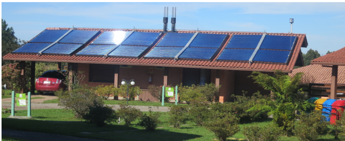
Painéis de energia solar fixados no telhado de um dos prédios do Hotel
