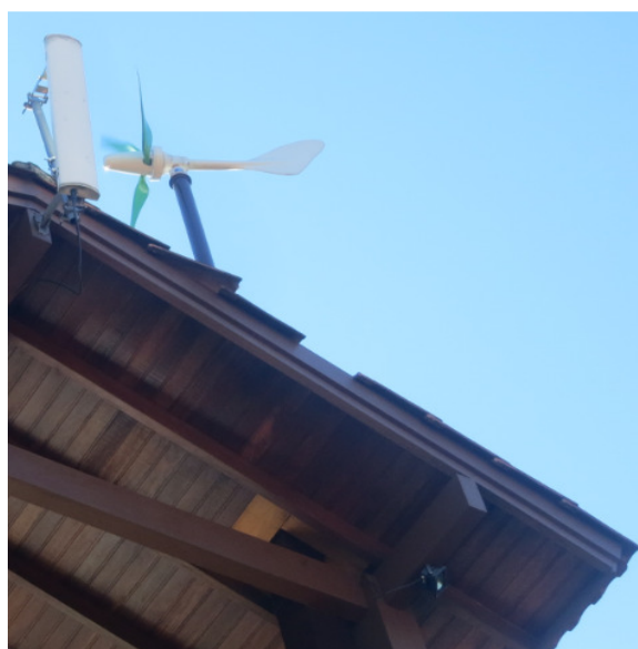
Gerador eólico no telhado
