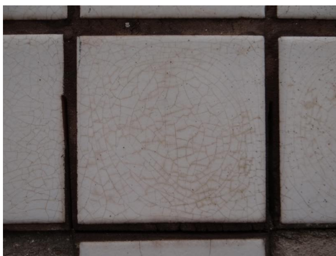
Figura 2.17 – Detalhe de cerâmica gretada (LEM- UnB, arquivo fotográfico).
