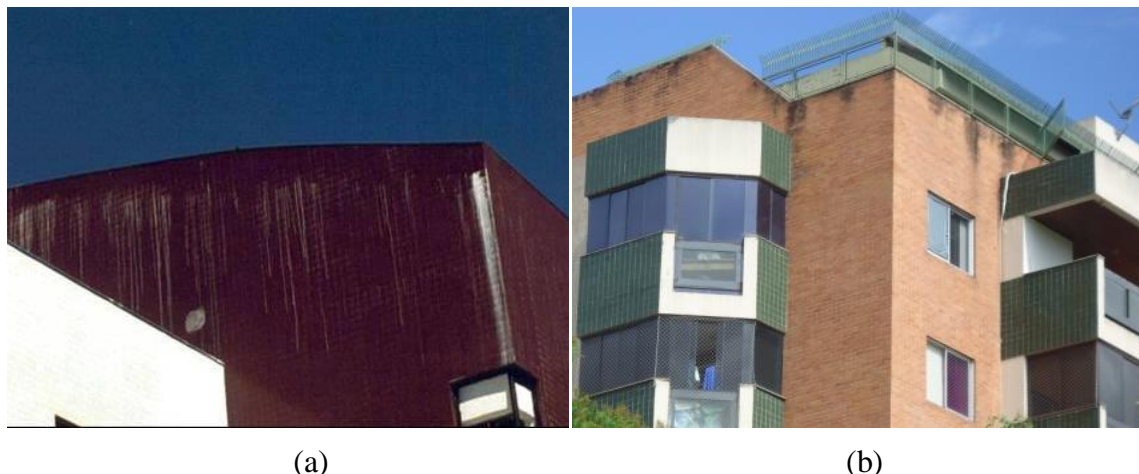
Figura 2.15 – (a) Eflorescências e (b) Manchas nas fachadas com revestimento cerâmico.
