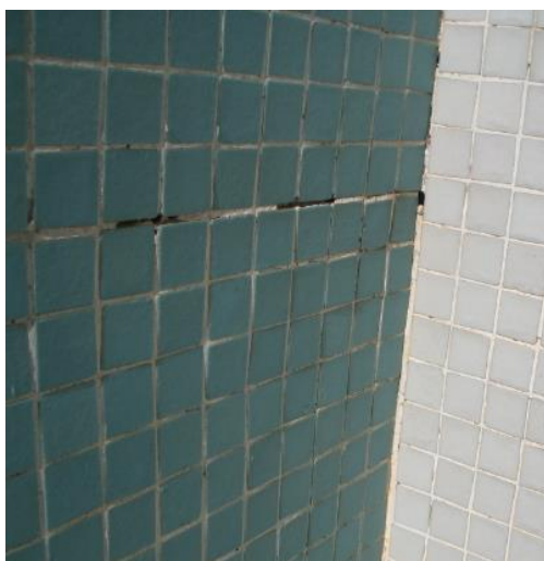
Figura 2.14 – Falha de rejunte (LEM-UNB, arquivo fotográfico).
