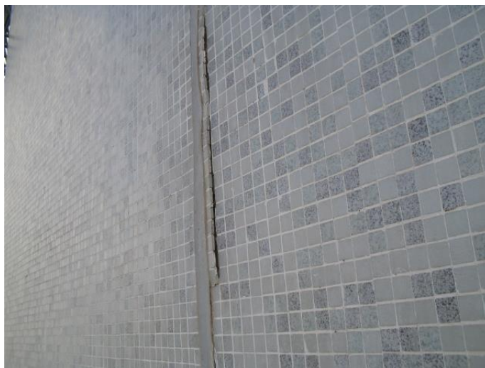
Figura 2.13 – Falha na junta (LEM-UnB, arquivo fotográfico).
