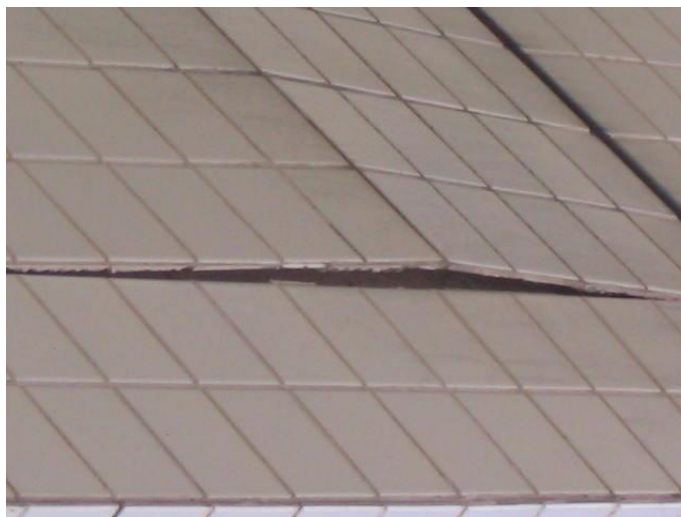
Figura 2.11 – Descolamento de placas cerâmicas (LEM- UnB, arquivo fotográfico).
