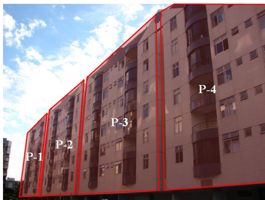
Figura 4.8 – Divisão da amostra de fachada (ER – 011) em quatro prumadas (P-1, P-2, P-3 e P-4) entre as juntas de movimentação estrutural.
