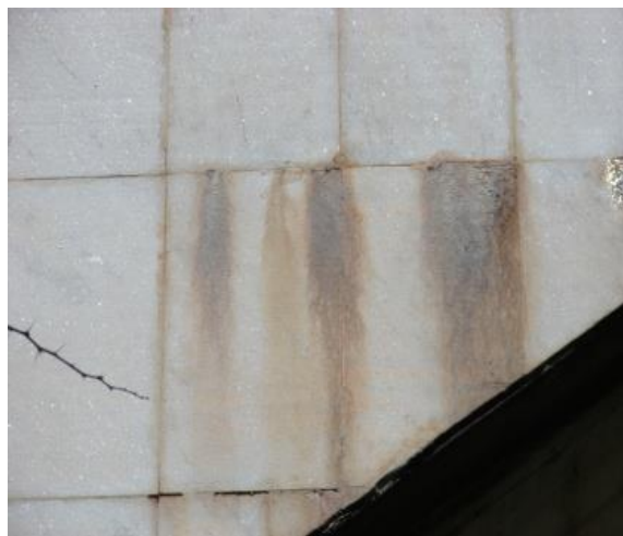
Figura 2.9 – Manchas no revestimento cerâmico (LEM- UnB, arquivo fotográfico).
