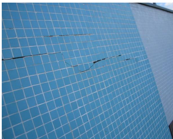
Figura 2.10 – Fissuras em revestimento cerâmico (LEM- UnB, arquivo fotográfico)
