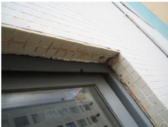
Figura 2.16 – Detalhe de falha de vedação (LEM- UnB, arquivo fotográfico).
