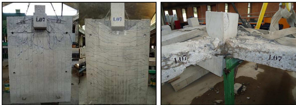
Figura 4.18 – Visão geral de fissuração nas faces superior, inferior e no corte da laje L07
