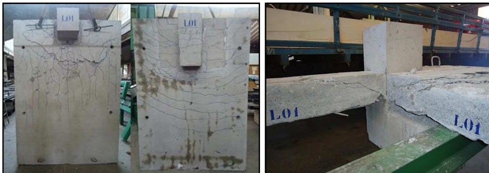
Figura 4.6 – Visão geral de fissuração nas faces superior, inferior e no corte da laje L01
