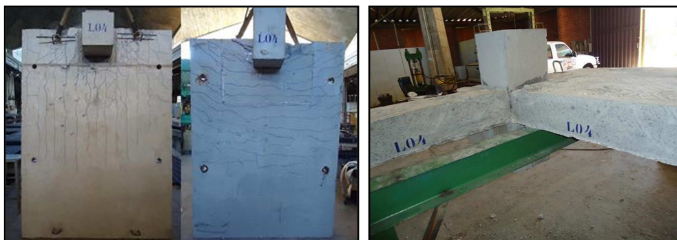
Figura 4.12 – Visão geral de fissuração nas faces superior, inferior e no corte da laje L04
