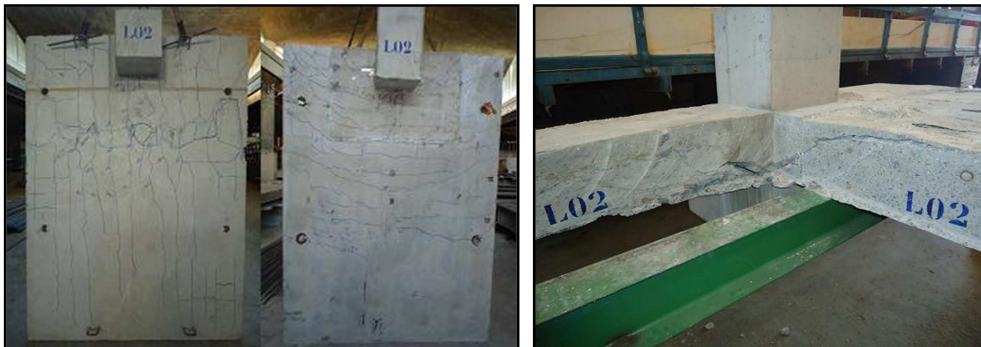
Figura 4.8 – Visão geral de fissuração nas faces superior, inferior e no corte da laje L02
