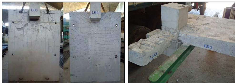
Figura 4.10 – Visão geral de fissuração nas faces superior, inferior e no corte da laje L03
