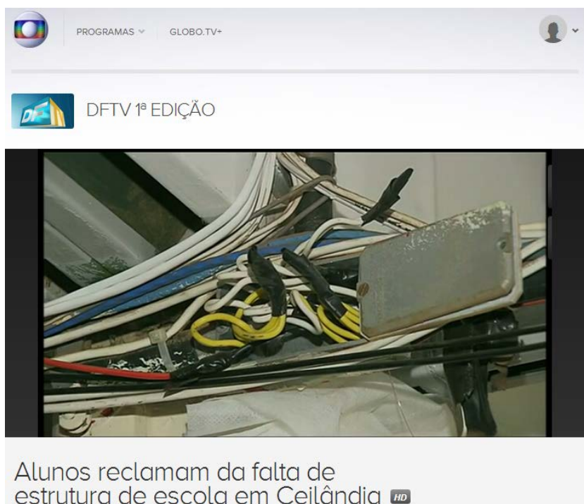
Figura 13 – Fiação exposta – CILC
