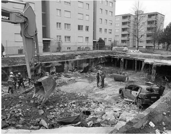
(a) Estrutura colapsada
