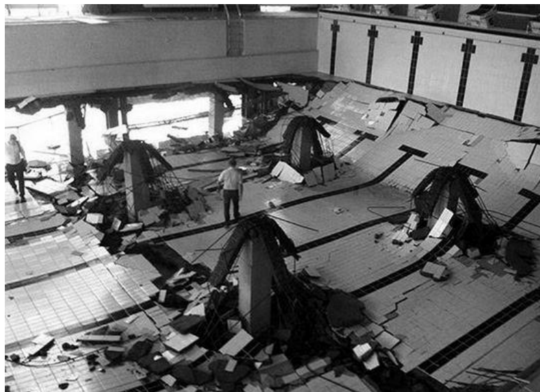
Figura 2.5 - Colapso de estrutura em Krasnodar, Rússia (ITAR-TASS News Agency)
