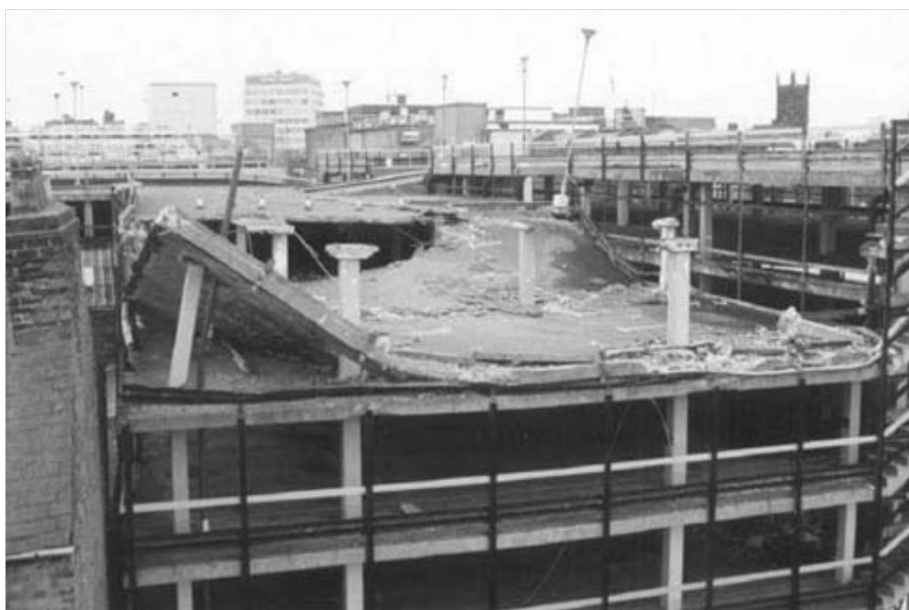
Figura 2.3 - Ruína no edifício Pipers Row Car Park, Wolverhampton (WOOD, 2001)
