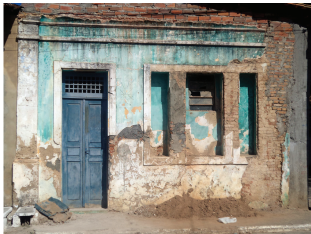
Detalhe de uma das fachadas. Casa abandonada depois de sofrer varias intervenções. – Tipologia 01. Foto Suzete Bomfim, 2013.
