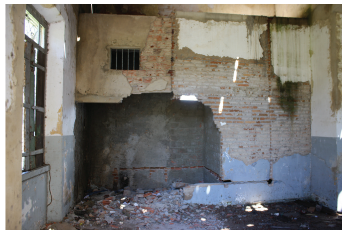
Detalhe do interior do edifício da antiga Estação – Paredes quebradas e com rachaduras e eflorescências. Foto: Suzete Bomfim, 2013.
