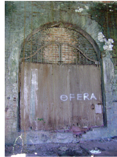
Detalhe da Vista interior - fechamento de um dos pórticos com parede de alvenaria de tijolos e chapas de compensado de madeira. Paredes com rachaduras e efflorescências. Foto: Suzete Bomfim, 2012
