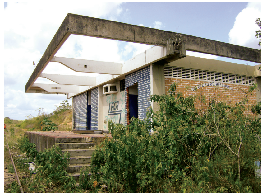
Prédio da Estação ferroviária em estado de abandono. Foto: Tamyres Fontelene, 2013.
