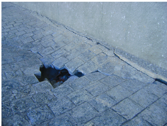
Detalhe da calçada em torno do edifício, muitas rachaduras e deformações. Foto: Suzete Bomfim, 2012.
