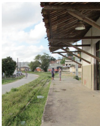
Plataforma de espera dos passageiros e sua cobertura por beiral de estrutura de madeira e telha cerâmica tipo colonial. Trilhos paralelos à Estação. Foto: Suzete Bomfim, 2013.
