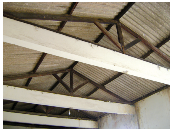
Interior da cobertura, vigas de concreto que servem de apoio para as tesouras de madeira que apoiam as telhas de fibrocimento. Foto: Suzete Bomfim, 2012.
