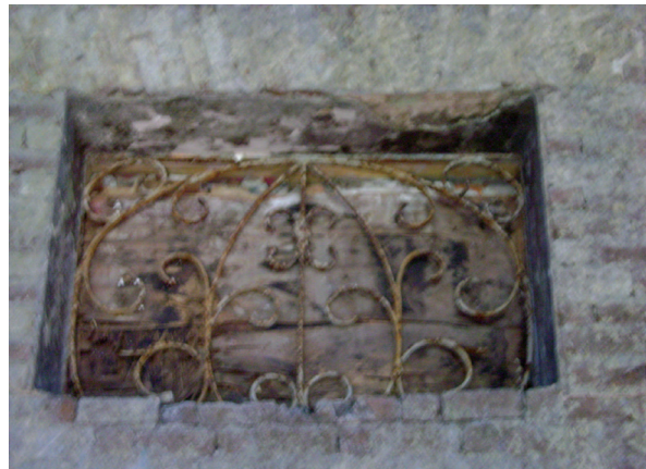
Detalhe da Vista interior - fechamento de uma das com parede de alvenaria de tijolos e chapas de compensado de madeira. Paredes com rachaduras e efflorescências. Foto: Suzete Bomfim, 2012
