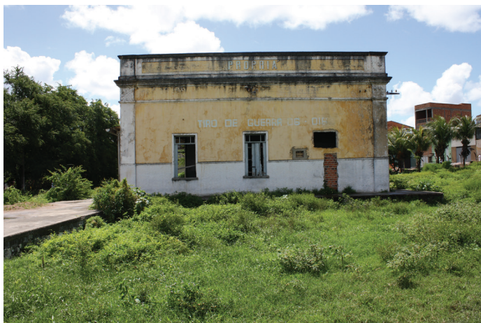
Fachada lateral, com descaracterização da sua forma original, por intervir no modelos da esquadria original e tirando a simetria do edifício. Foto: Suzete Bomfim, 2013.
