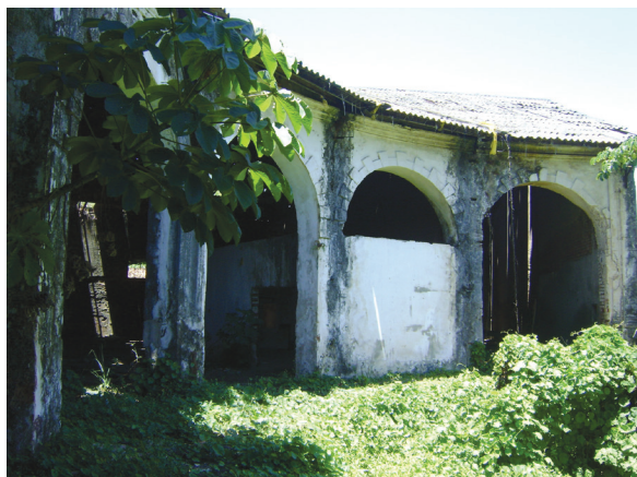
Detalhe da fachada da Rotunda. Algumas alterações da planta original, como o fechamento de uma das aberturas com parede de alvenaria. Paredes com rachaduras e eflorescências. Foto: Suzete Bomfim, 2012.
