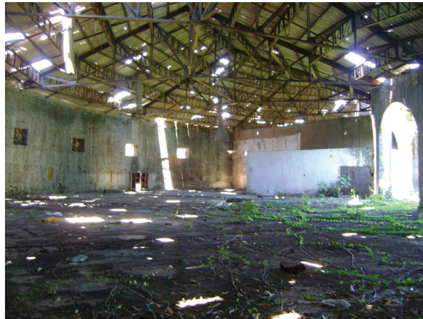
Detalhe da fachada da Rotunda. Algumas alterações da planta original, como o fechamento de uma das aberturas com parede de alvenaria. Paredes com rachaduras e efflorescências. Foto: Suzete Bomfim, 2012.
