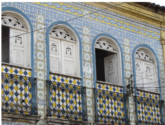
Fachada descaracterizada, com fechamento dos antigos balcões e aplicação de cerâmica 10x10, evidenciando a diferença de tipos de revestimento ao longo dos anos. Uso atual: Sorveteria. Praça Matriz. Foto: Suzete Bomfim, 2013.
