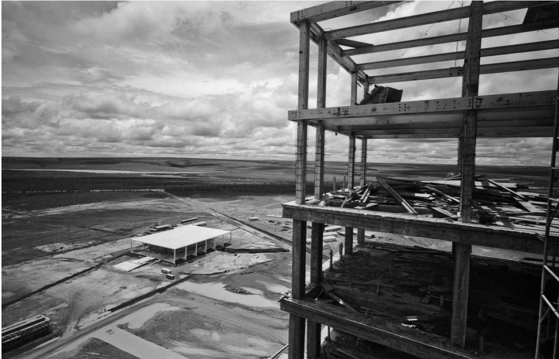
FIGURA 52 - Thomaz Farkas - Praça dos Três Poderes em construção com o Supremo Tribunal Federal ao centro - 1958. Fotografia.
