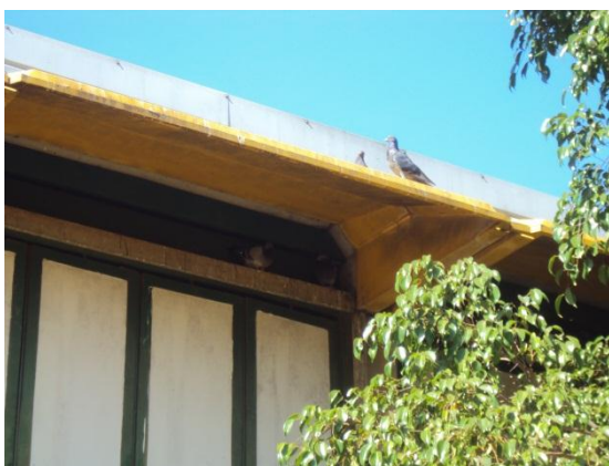
Figura 18: Pouso e nidificação de pombos no telhado do bloco de salas de aula.
