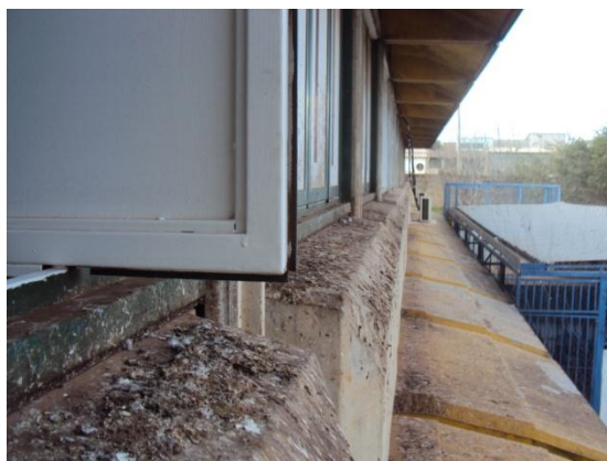
Figura 19: Sujidades, fezes e penas, no parapeito das janelas das salas de aula.
