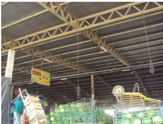
Figura 12: Galpão em Feira com exposição de frutas e verduras e presença de pombos nas vigas de sustentação do telhado, Ceilândia – DF.
