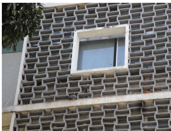
Figura 4: Edifício residencial com problemas de nidificação e pouso de pombos, Brasília - DF.
