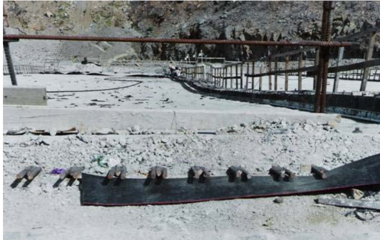
Figura 2.14 – Aspectos das ondulações da laje provocada pelos recalques do maciço (Hidroservice, 1993).
