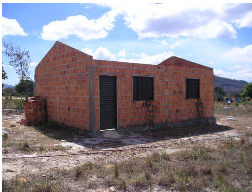
Foto 11 – obra inacabada programa da AGEHAB. Crédito: Jônatas Barreto
