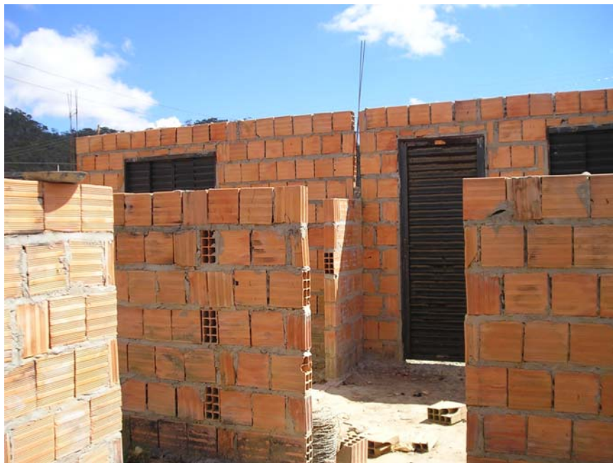
Foto 12 – obra inacabada programa da AGEHAB. Crédito: Jônatas Barreto
