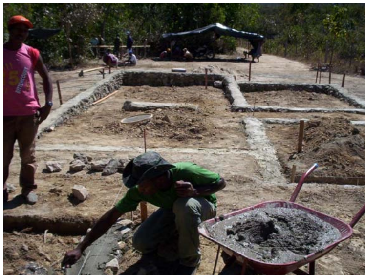
Foto 18 – Fundações em pedra da casa de adobe do Ação Kalunga em limoeiro Crédito: Jônatas Barreto
