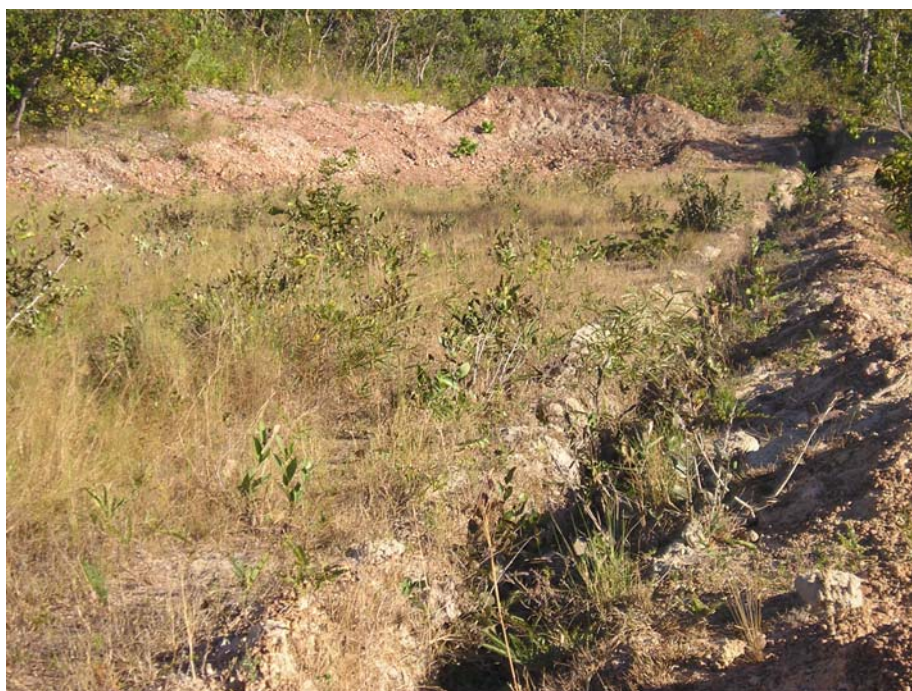
Fotos 28 e 29 – Obra paralisada virando erosão Crédito: Jônatas Barreto
