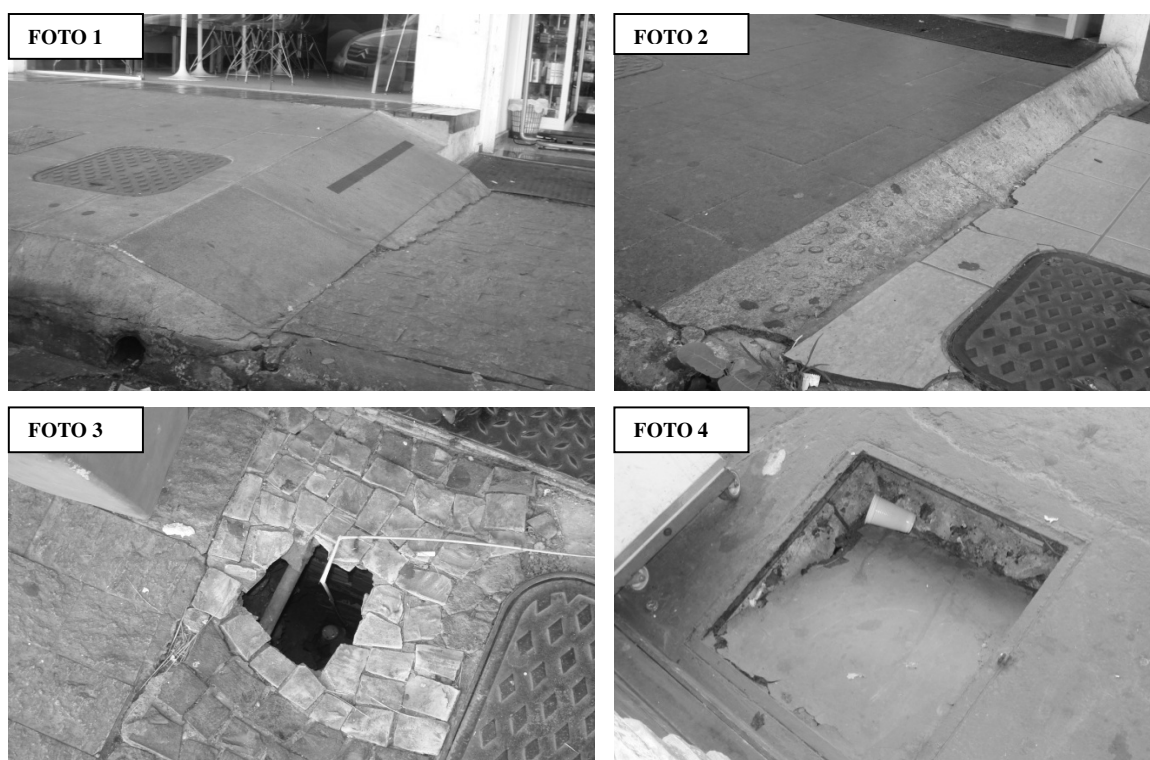
Figura 5.53: Foto 1 e 2, rampas 209SBR1 e 209SBR2; Fotos 3 e 4, calçada de bloco
