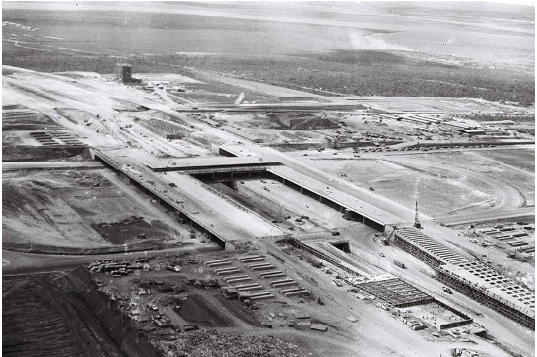
Figura 11. Brasília. Construção da plataforma superior da estação Rodoviária. Fonte: Arquivo Público do DF (1960).
