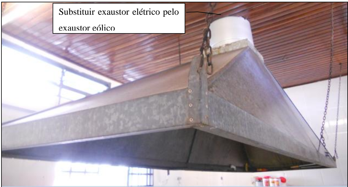
Figura 3.13 – Coifa da cozinha industrial.
