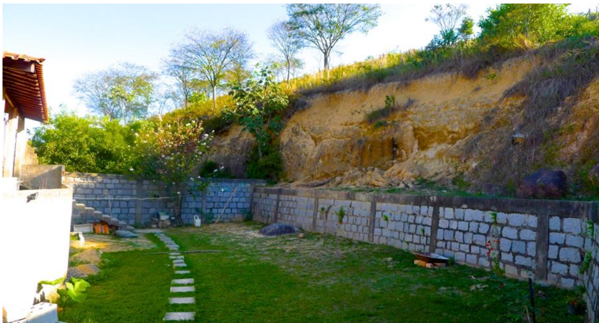
Fotografia 26 - Talude de corte em solo laterítico de rochas sedimentares do Membro Itatiaia da Bacia de Resende, acima de muro de quintal de casa em bairro da cidade de Itatiaia na Unidade de Terreno Colinas Sedimentares. Fotografia tirada próxima ao ponto 2.8.
