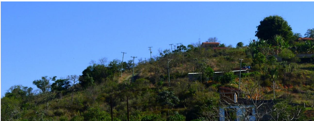
Fotografia 10 - Postes entortados em bairro implantado sobre morro de tálus na Unidade de Terreno Rampas e Morros de tálus. O entortamento dos postes é uma feição característica da ocorrência de rastejo ( creeping ). Fotografia tirada no ponto 2.5.
