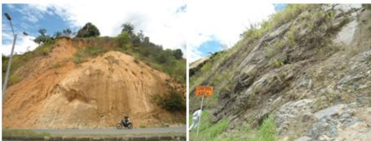
Figura 3.19. Taludes afetados pelos diferentes processos morfodinâmicos.
