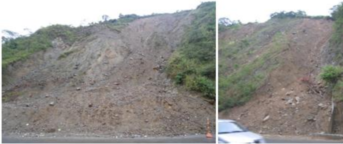
Figura 3.16. Processos erosivos superficiais.
