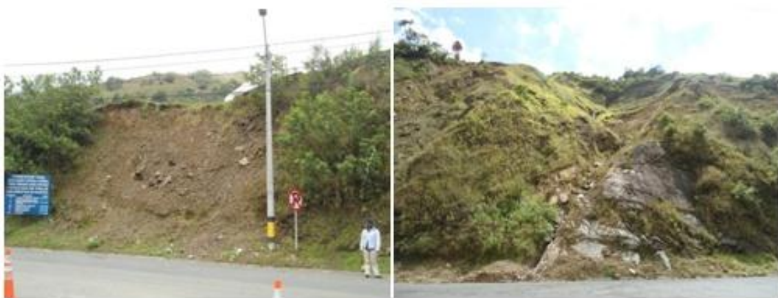
Figura 3.18. Processos erosivos detonantes de vários danos nos taludes.
