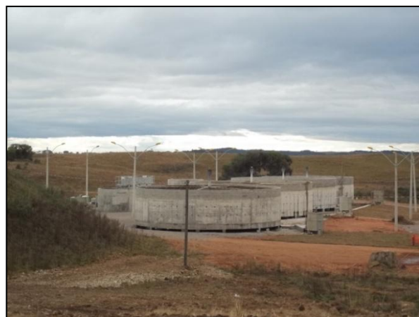
Figura 54: Tanques para tratamento do líquido percolado. SCHLINDWEIN, J.R. 25/05/2012.
