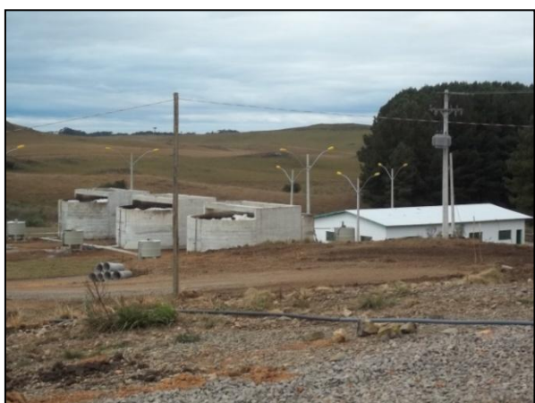
Figura 55: Tanques para tratamento do líquido percolado. SCHLINDWEIN, J.R. 25/05/2012.
