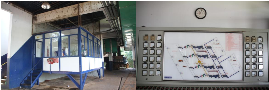
Figura 6.16 – Central de controle e comando e foto do painel da IRR Asa Sul – Tecnologia Dano Fotos: Kátia Campos Brasília – 2012
