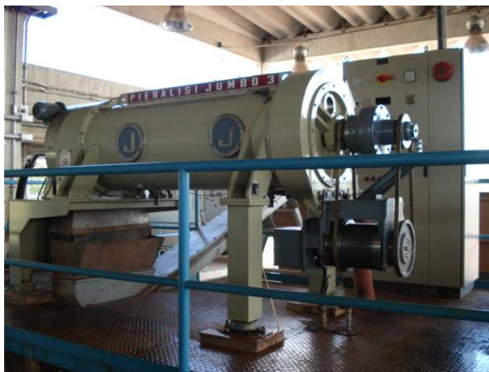
Figura 4.5 – Centrífuga da unidade de desidratação de lodo da ETA-Descoberto
