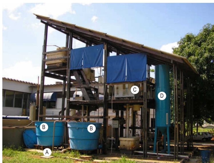
Figura 4.7 – Estação piloto da ETA-Brasília: (A) Chegada de água de lavagem; (B) Tanques de acumulação de água de lavagem; (C) Tanque de flotação; (D) Coluna de sedimentação;
