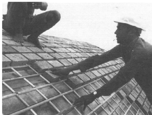
Figura 35. Disposição dos tijolos durante a execução de uma abóbada de berço. Os separadores ajudam a posicionar os tijolos antes de colocar a armadura de aço e a argamassa.
