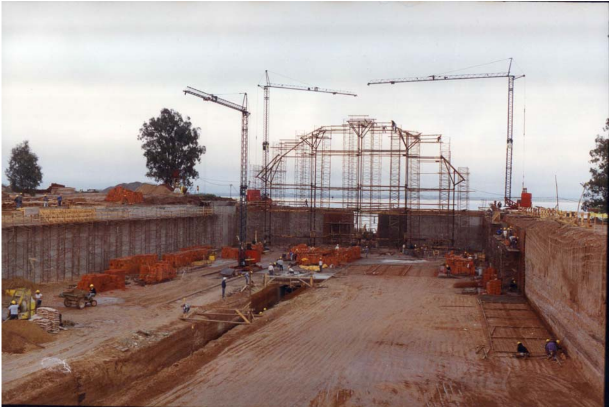
Figura 62. Celeiro horizontal Corporacion de Navios em construção. Ao fundo, os andaimes para construir as abóbadas de dupla curvatura.
