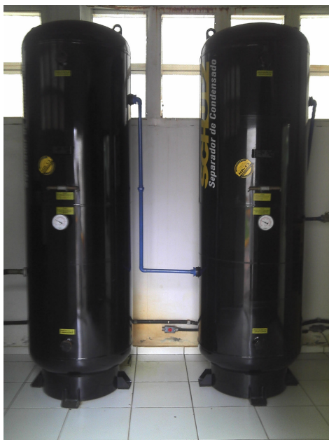
Figura 12. Sala de compressores 1
