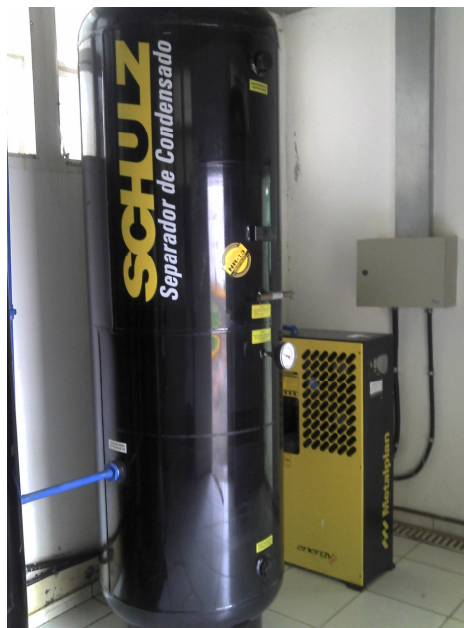
Figura 13. Sala de compressores 2
