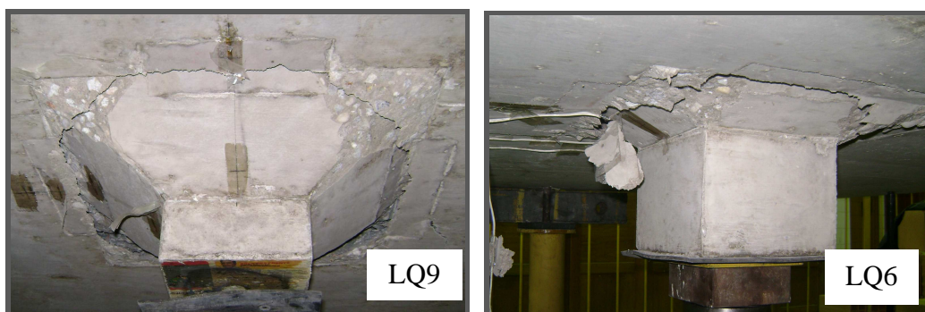
Figura 6.4 – Abaulamento nos cantos dos capitéis das lajes LQ9 e LQ6, respectivamente
