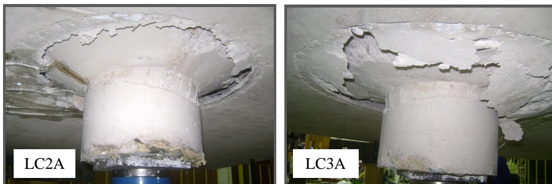
Figura A.1 – Ruptura externa e interna, das lajes L2A e L3A, respectivamente.
