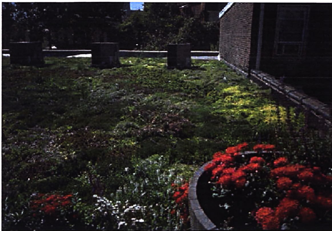
Foto 3.1: Telhado verde instalado no teto da academia de esgrima de Filadélfia (MILLER e EPA, 2000).
