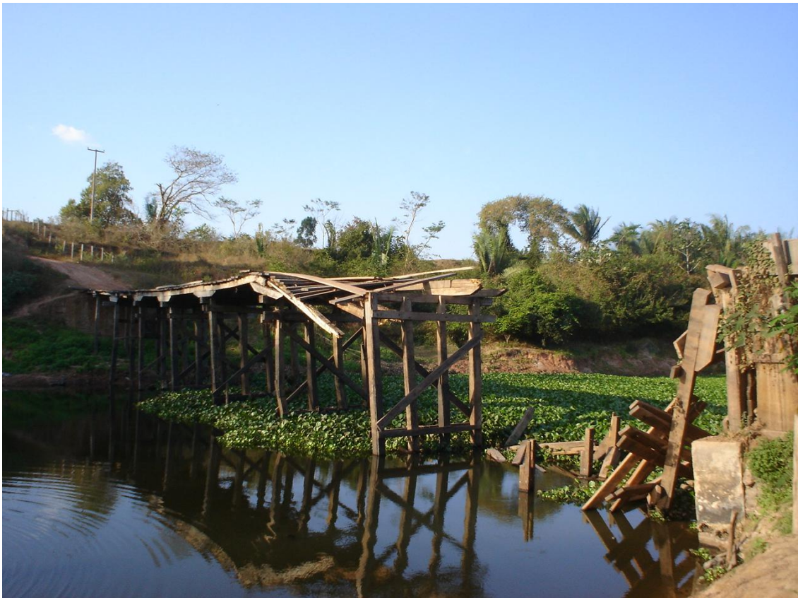
Figura 12 - Dificuldade de acesso, ponte quebrada no acesso ao Povoado Mata de Ana, município de Bacabal (MA)
