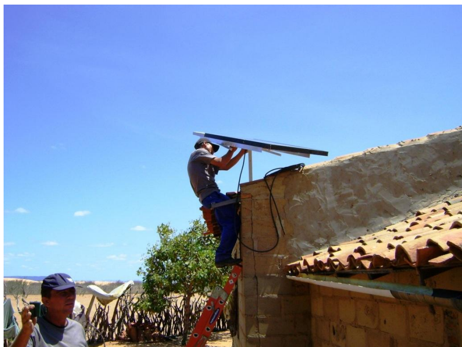
Figura 34 - Dificuldade de acesso, comunidades isoladas e novas tecnologias (sistema fotovoltaicos) (2), Ilha do Zé Rocha (BA)
