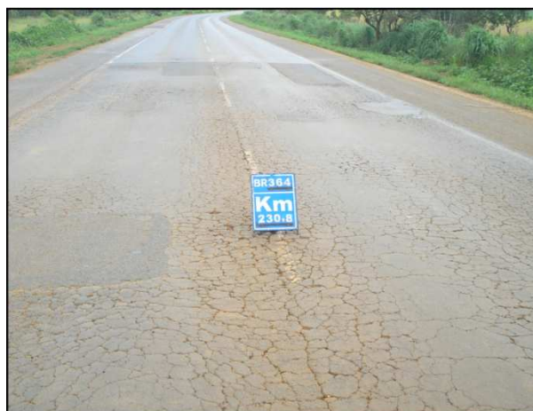
Figura 2.2 – Trincamento por fadiga.
