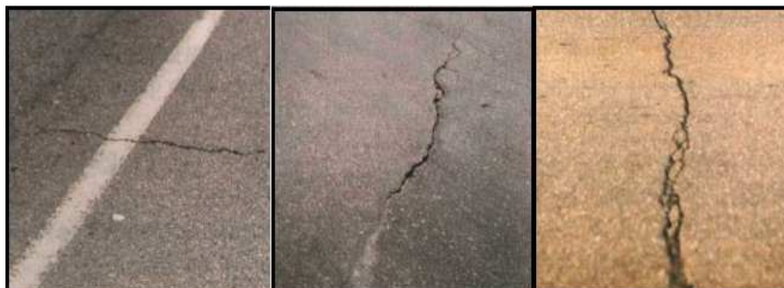
Figura 2.4 – Trincas transversais (Matte, 2006).
