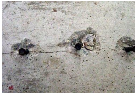
Figura 2.27- Fissuração superficial causada por cravações sucessivas (PINTO e DUTRA, 2005).
