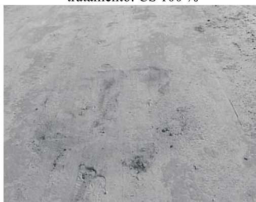
Buracos de baixo nível de severidade, encontrados nos trechos com os seguintes tratamentos: CS 100 %, LC 50 % - CS 50 % e LC 70 % - CS 30 %
