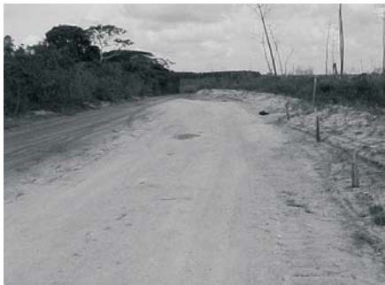
Seção transversal imprópria e drenagem inadequada, ambas de baixo nível de severidade
