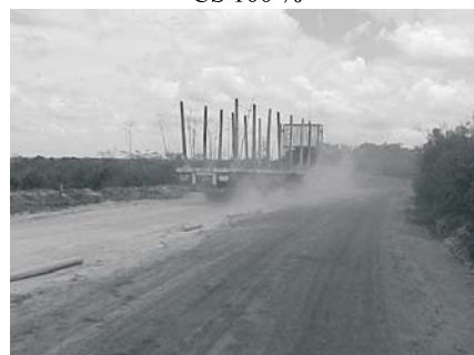
Excesso de poeira com Alto nível de severidade, observado no trecho com o seguinte tratamento: LC 70 % - CS 30 %
