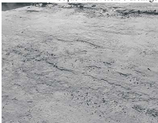
Perda de agregado de baixo nível de severidade, observada no trecho com o seguinte tratamento: CS 100 %
