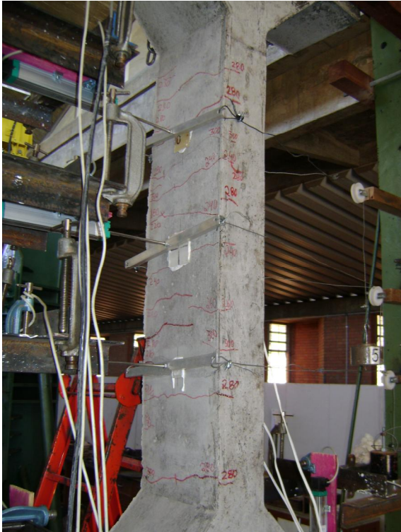
Figura 4.22 – Fissuras do pilar PFN 30-2
