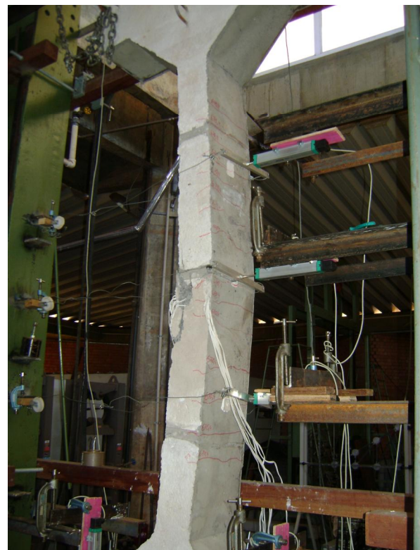
Figura 4.13 – Fissuras do pilar PFN 15-2,5
