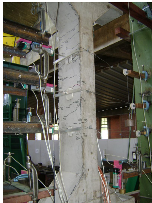
Figura 4.21 – Fissuras do pilar PFN 24-2
