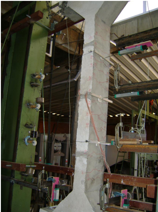
Figura 4.18 – Fissuras do pilar PFN 60-2,5
