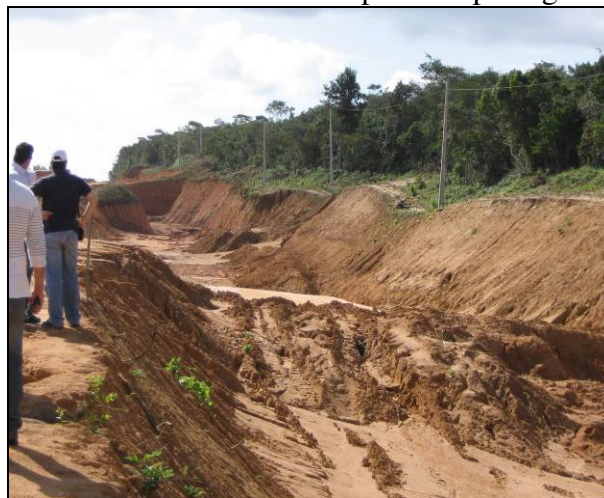
Figura 5.32 - Instabilidade de taludes após terraplenagem inadequada.
