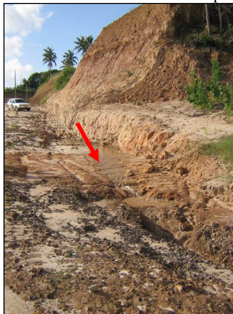
Figura 5.24 - Processos erosivos decorrentes da supressão de vegetação.
