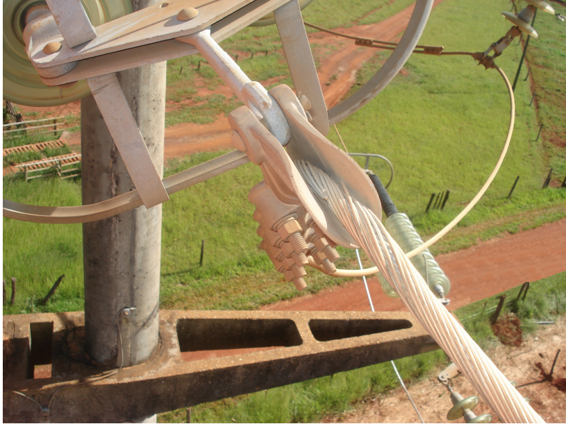
Figura 2.14 - Fadiga por fretting no cabo condutor, localizada no grampo de ancoragem
