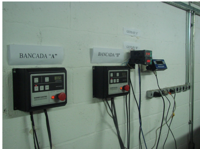
Figura 3.13 – Painel de controle da carga de pré-esticamento aplicada no cabo
