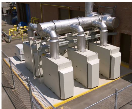
Figura 2-22 Planta de cogeração utilizando 6 microturbinas de 60 kW cada, fornecendo calor a um chiller de absorção 3 de 520 kW (foto: Capstone Turbine Corporation , 2006).
