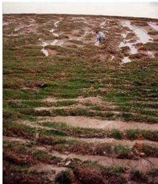
Figura 2.6 – Deslizamento do solo de cobertura sobre GCL devido a ocorrência de forças de percolação, após uma tempestade (Gross et al., 2002).
