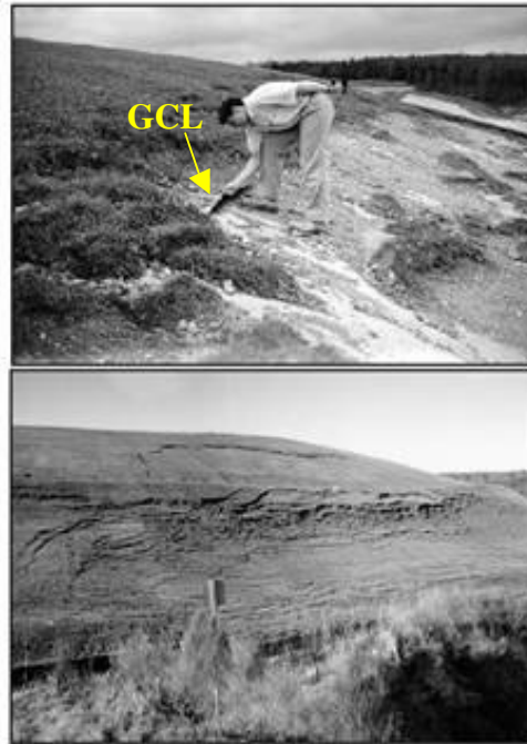
Figura 2.5 – Problemas com talude de um sistema de cobertura – Deslizamento do solo de cobertura promovendo a ruptura do GCL (Dwyer et al., 2002).
