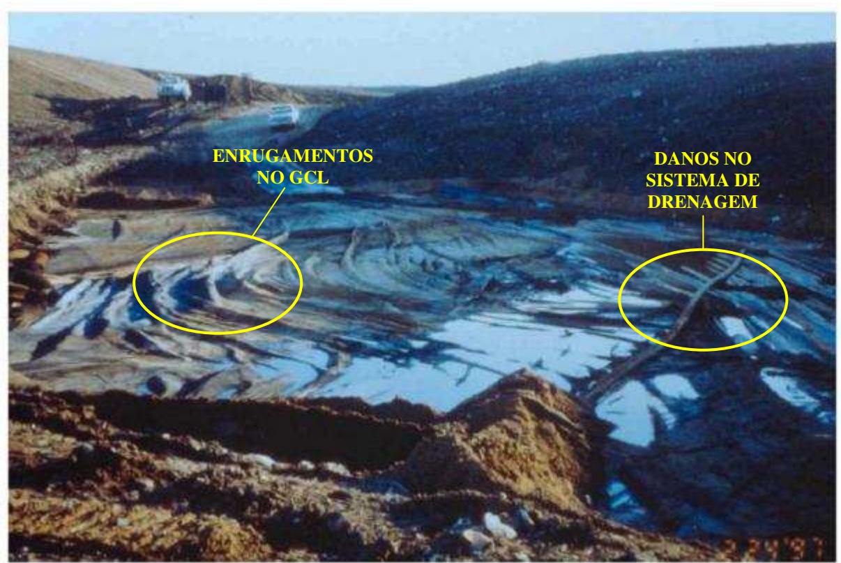
Figura 2.7 - Escavação do resíduo na zona de ruptura, ocorrência de grandes enrugamentos no GCL e danos no sistema de drenagem (modificado – Gross et al., 2002).
