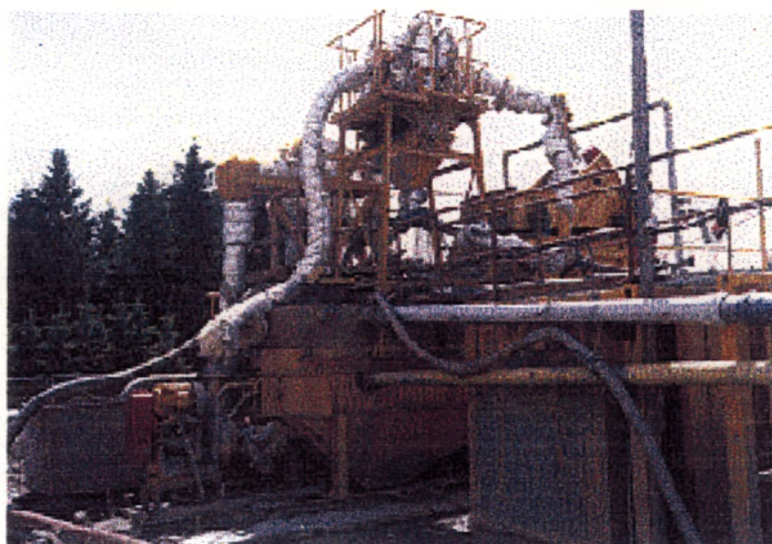
Figura 4.19 - Central de recuperação de bentonita
