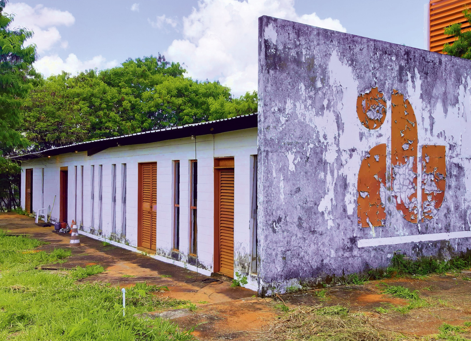
Figura 101. Sede provisória do IAB-DF em 2024. O pavilhão encontra-se sem uso desde a pandemia de Covid-19, quando o espaço foi ocupado e severamente danificado. Com a perspectiva de demolição para construção da sede do CAU-BR e IAB-DF, o IAB deliberou por não executar as reformas necessárias à reabilitação do espaço. Foto do autor. Fonte: Acervo IAB-DF.
