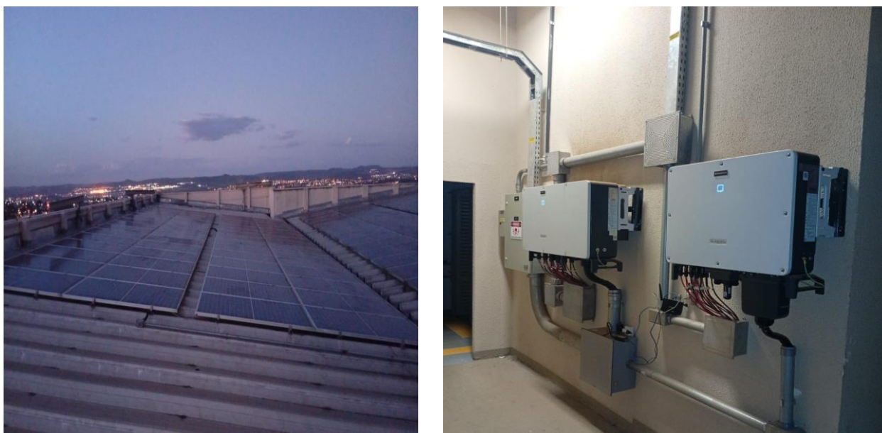
Figura 3.27 - Vista da usina solar e os dois inversores localizados no barrilete da edificação existente.
