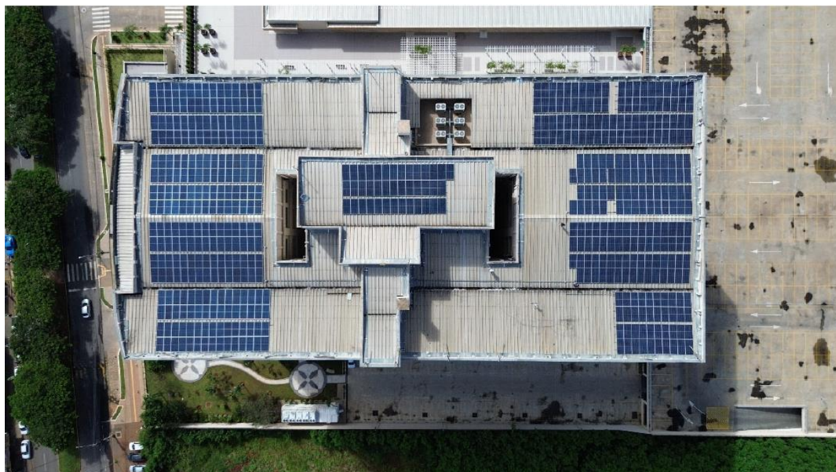
Figura 3.28 - Imagem aérea da cobertura do edifício avaliado com as placas do sistema solar fotovoltaico ligado à rede.
