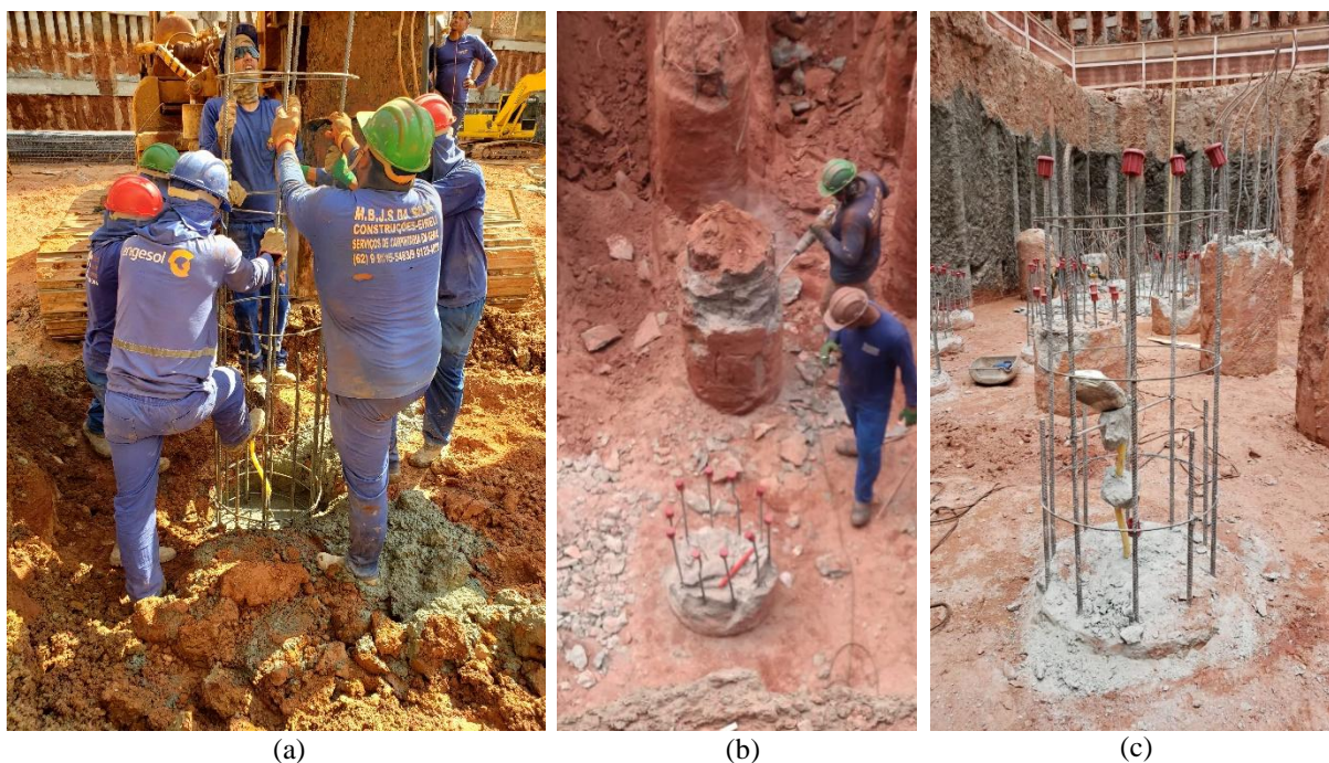
Figura 3.61. Sequência executiva das estacas instrumentadas: (a) execução; (b) arrasamento; e (c) cabos localizados e preservados após o arrasamento.
