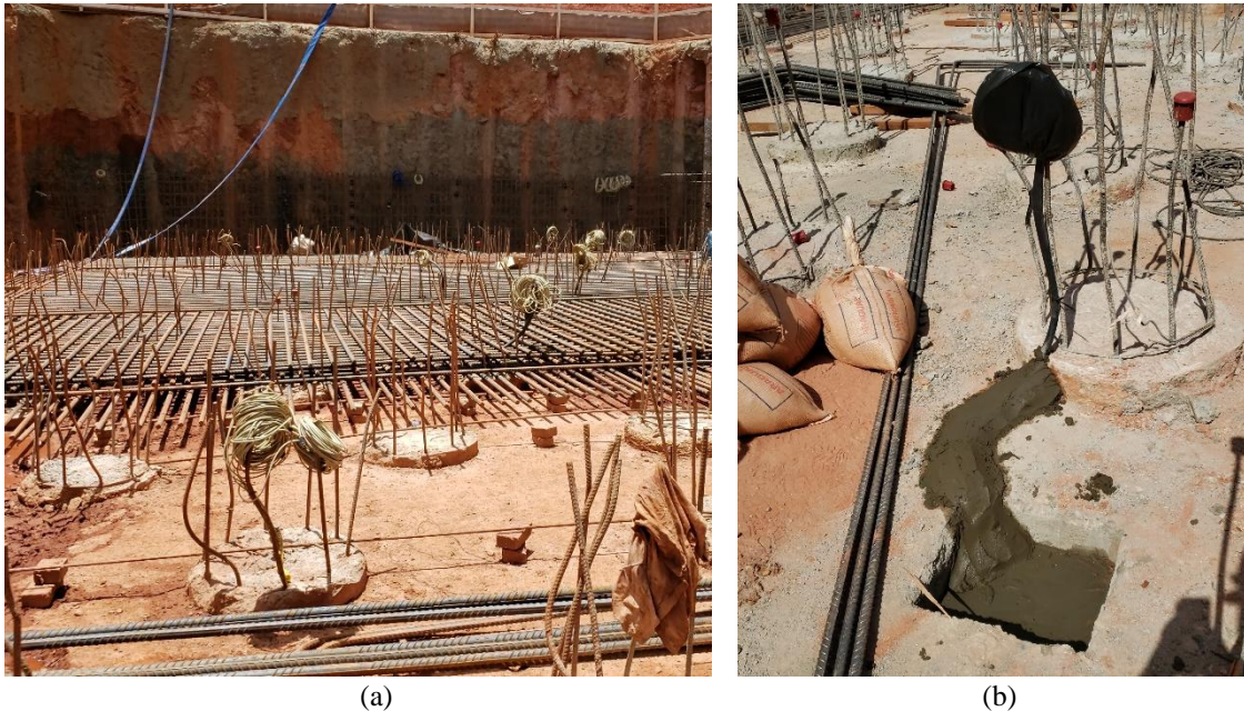
Figura 3.62. Condução dos cabos da instrumentação: (a) dos SI nas estacas; (b) das CTT.
