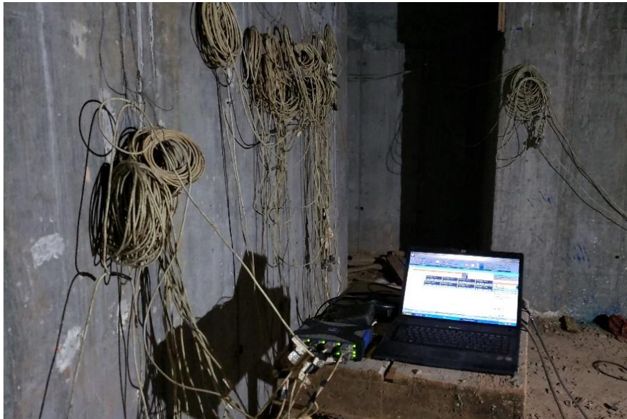
Figura 3.67. Central de monitoramento no fosso de serviço dos elevadores acima do radier.
