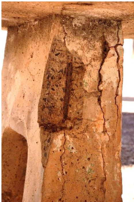
Figura 43 – Sinais de esmagamento no elemento de concreto aparente. Fonte: da autora.
