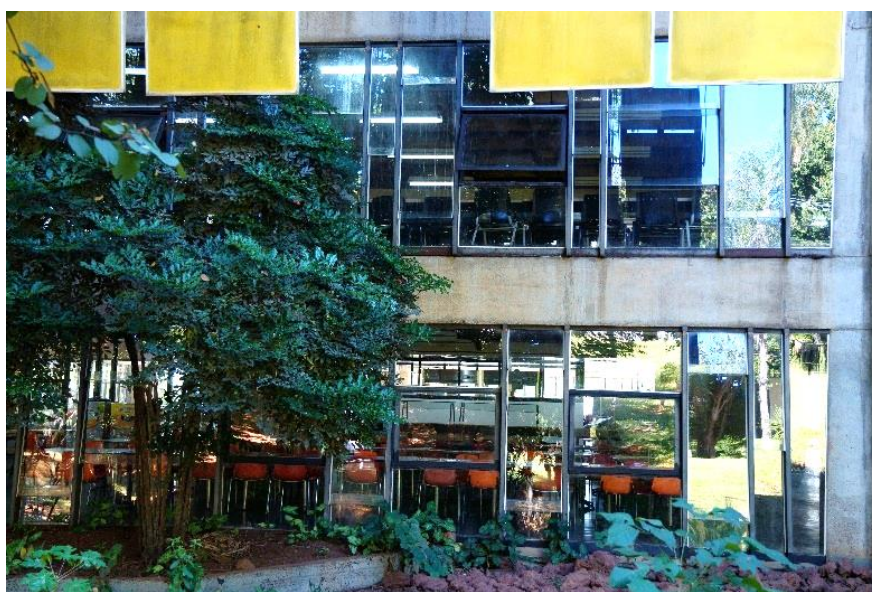
Figura 127 – Presença de vegetação próxima a vigas e pilares na fachada sudoeste.
