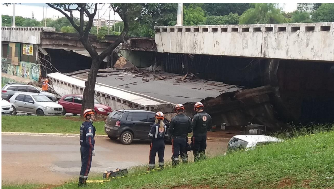
Figura 15 – Desabamento do viaduto.
