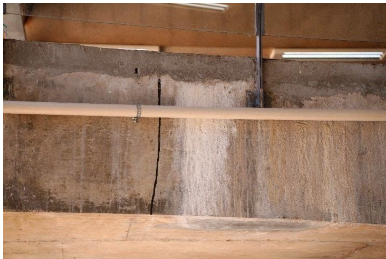
Figura 36 – Manchas de eflorescência em uma laje de concreto aparente. Fonte: da autora.
