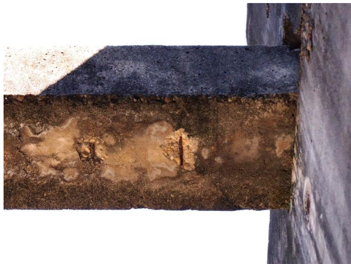
Figura 39 – Falha de concretagem com exposição de agregados e de armadura na viga de concreto aparente.
