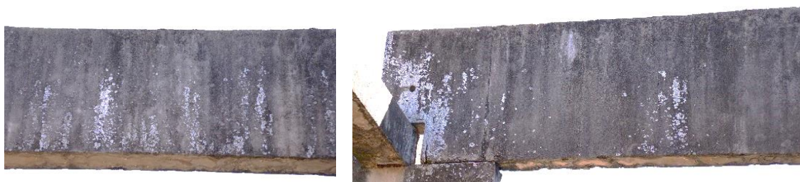
Figura 51 – Incidência de líquens em superfícies de concreto aparente.
