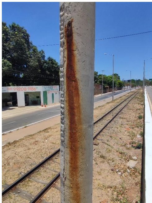
Figura 35 – Mancha de corrosão no concreto aparente. Fonte: da autora.
