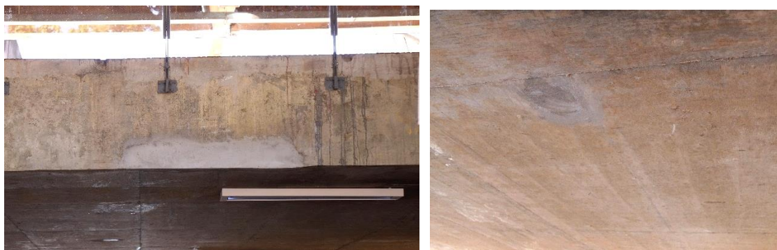
Figura 47 – Preenchimentos de argamassa em elementos de concreto aparente. Fonte: da autora.
