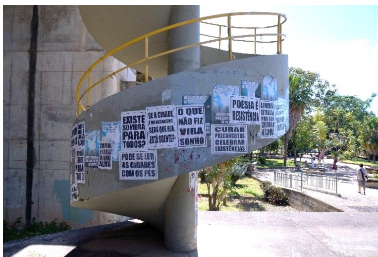
Figura 119 – Pintura cinza claro e cartazes na escada E1 da fachada nordeste.
