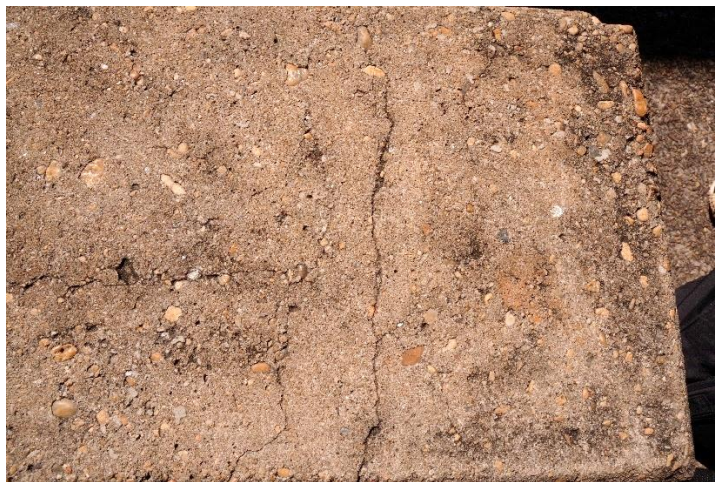
Figura 41 – Fissuras de pequena abertura no concreto aparente. Fonte: da autora.
