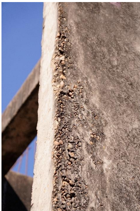
Figura 38 – Falha de concretagem na borda de um pilar com leve exposição de agregados no concreto aparente.
