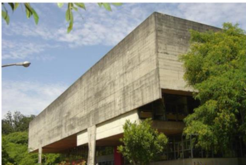
Figura 33 - Fachada da FAUUSP com alteração da imagem por ação de manifestações patológicas. Fonte: (SIMÕES, 2004).
