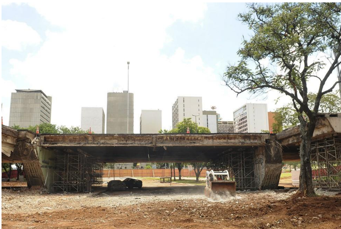
Figura 16 - Pilares que Restaram no Viaduto da Galeria dos Estados logo após o desabamento da estrutura.
