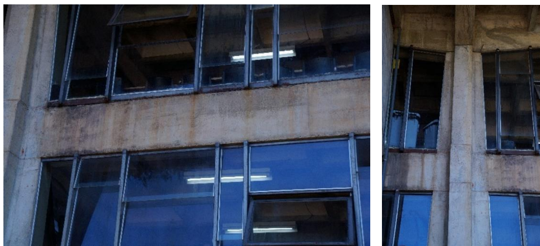
Figura 49 – Sujidades acumuladas em elementos de concreto aparente. Fonte: da autora.
