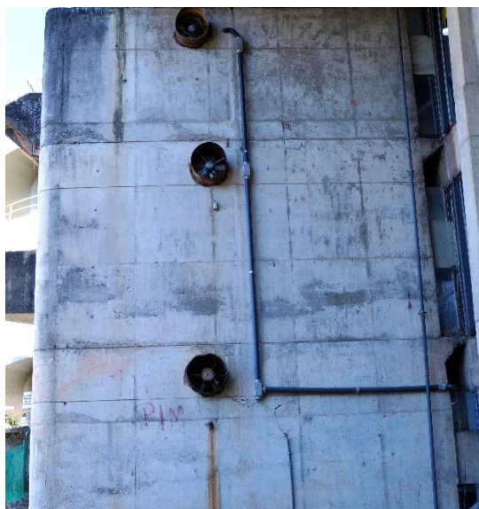
Figura 48 – Tubulações e eletrodutos externos em parede de concreto aparente. Fonte: da autora.
