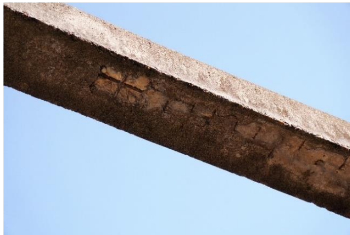
Figura 40 – Desplacamento incidente na parte interior de uma viga de concreto aparente. Fonte: da autora.
