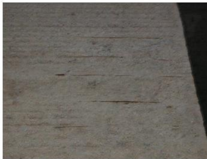
Figura 26 – Cobrimento deficiente da armadura do pilar da fachada do Palácio da Justiça em 2007. Fonte: (MOREIRA, 2007).
