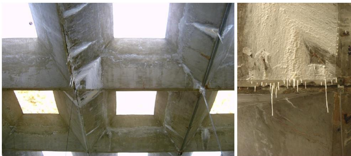
Figura 21 - Eflorescência de carbonato de cálcio na cobertura da FAUUSP. Fonte: (CASTRO et. al. , 2016).
