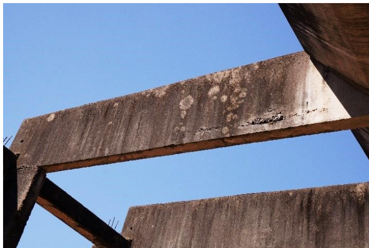
Figura 34 – Manchas de crosta negra no concreto aparente. Fonte: da autora.
