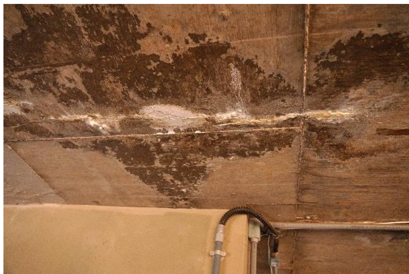
Figura 37 – Manchas de umidade incidentes em uma laje de concreto aparente. Fonte: da autora.
