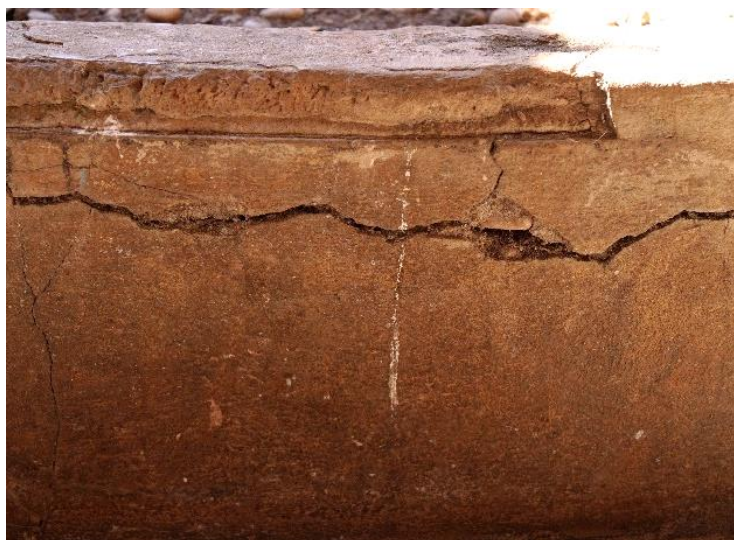
Figura 42 – Trincas de maiores aberturas no concreto aparente. Fonte: da autora.
