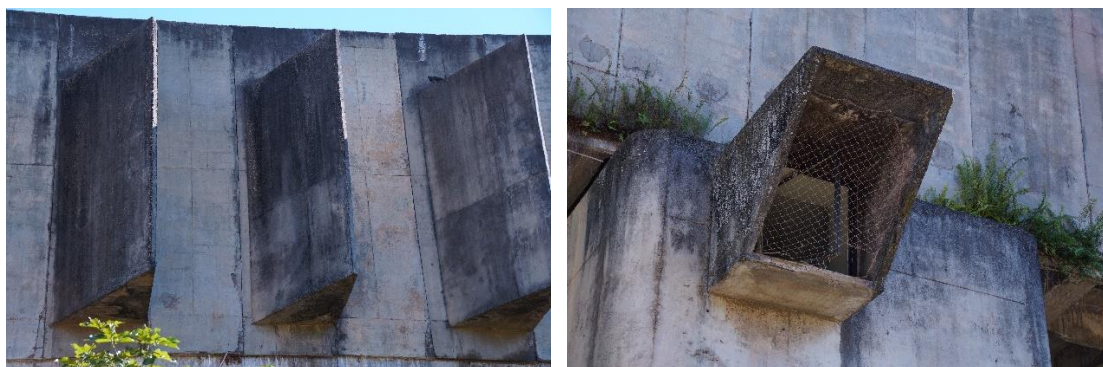
Figura 102 – Família de nichos que apresentou nível de incompletude muito alto na fachada nordeste. Fonte: da autora.
