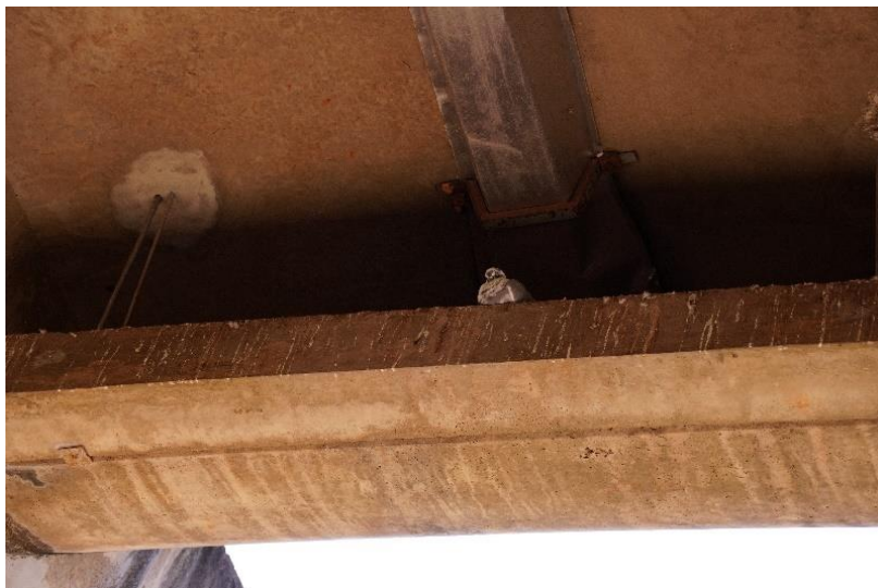
Figura 52 – Acúmulo de dejetos animais na superfície de concreto aparente. Fonte: da autora.
